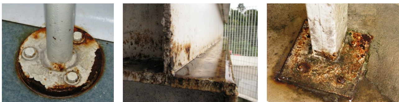
Figura 6 – Exemplos de corrosão nas estruturas metálicas das UPA 24h construídas em sistema modular.
