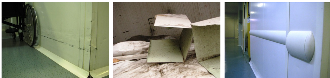
Figura 3 – À esquerda, Painel metálico danificado. No centro, nota-se a pequena espessura da chapa que compõe o painel e na imagem à direita, parede protegida por bate-maca resiste melhor a impactos.
