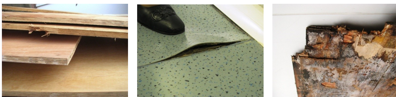
Figura 5 – Material utilizado na execução do piso de algumas unidades modulares, piso afundando e condição da chapa retirada após afundamento devido à umidade.
