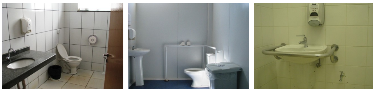
Figura 14 – À esquerda, sanitário em Formosa/GO, sem barras de apoio. No centro, sanitário no Núcleo Bandeirante/DF, com barras em altura acima do preconizado pela norma, que seria 75 cm, em desatendimento ao item 7.3.1.2 da NBR 9050. No mesmo banheiro também se observa lavatório sem barras de apoio e com coluna (desatendimento ao item 7.3.6.2). A imagem da direita mostra exemplo de lavatório adequado segundo a norma, com coluna suspensa e barra de apoio.
